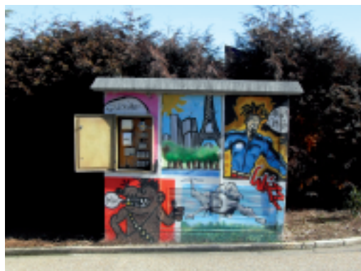
Armoire d'éclairage public sur un poste haut en couleur
